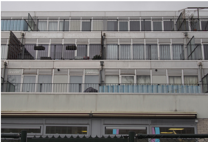
Fig. Details voor- en achteregevels van Reigersbos. De vervuiling, cv afvoeren en ventilatieopeningen zijn duidelijk te zien.
