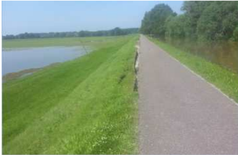
Abbildung 7: 08.06.13 – 10:37 Uhr, Initialbruch an der landseitigen Böschungskante.
