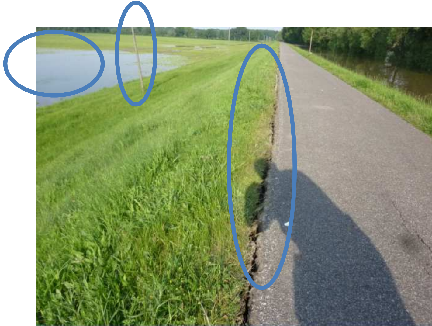
Abbildung 6: 08.06.13 – 08:26 Uhr, Rissbildung an der landseitigen Böschungskante
