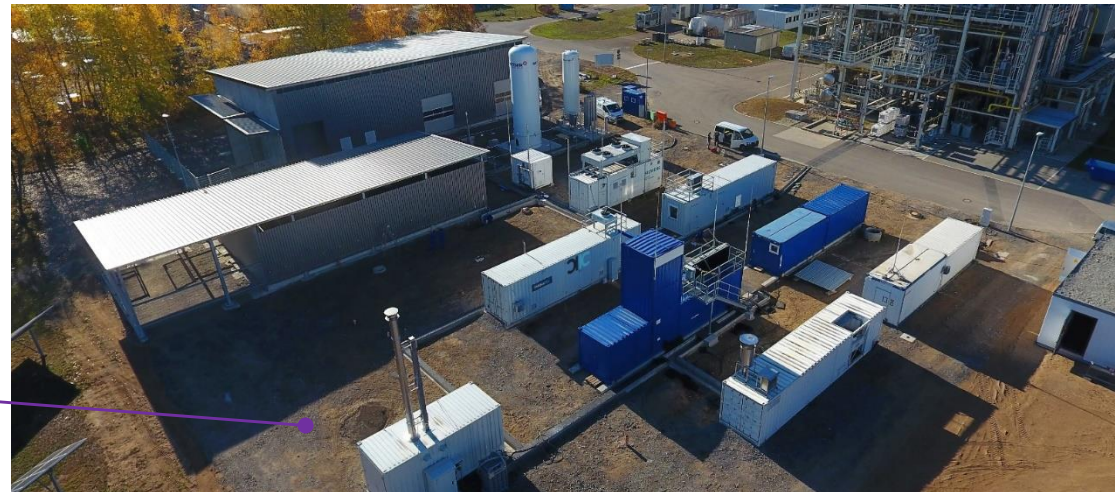
Energy Lab 2.0 am Standort des KIT, Quelle: INERATEC
